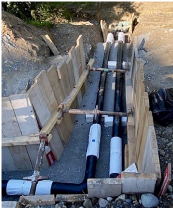
Fernwärmeleitung zur Siedlung Triemli 2
