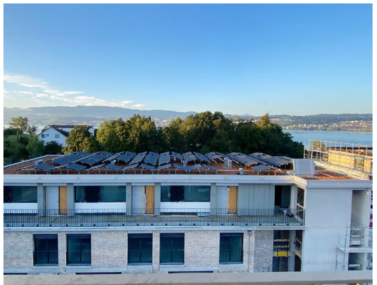
PV-Anlage der Siedlung Birchweid in Uetikon am See
