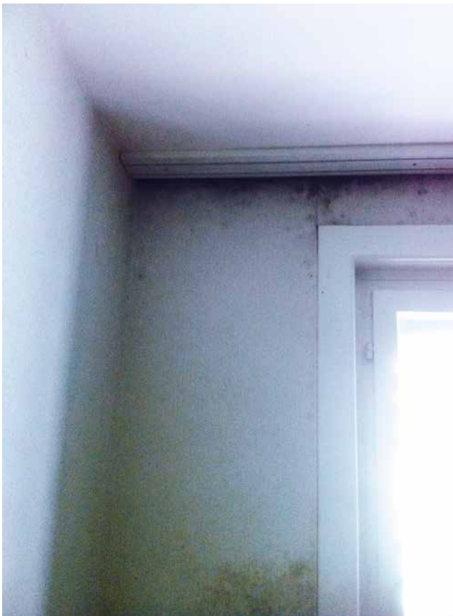
Schimmelbefall unter der Vorhangschiene
