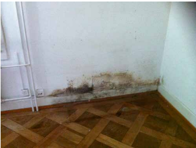
Schimmelpilz über der Sockelleiste
