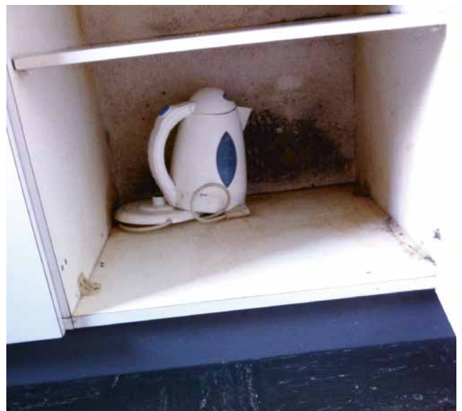
Schimmel in der Küchenmöbelung
